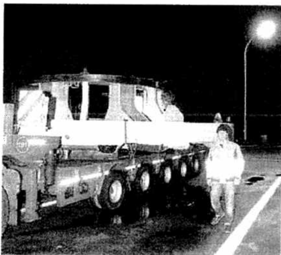
La testa della talpa arrivata sabato sera all'autogrill autostradale alle porte di Firenze prima di entrare, per il montaggio, al cantiere di Campo di Marte
